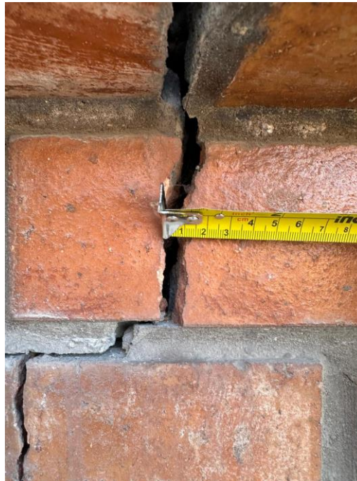
Figura 20 Espesor de la Grieta de 1 cm en la Zona Crítica Debajo de la Ventana Larga
