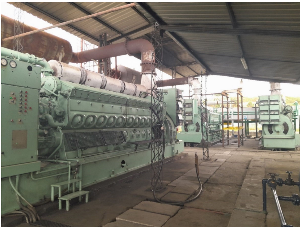
Figura 1 Grupos electrógenos General Motors – U4, U5, U6
