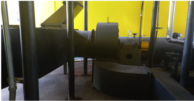
Foto. N° 04 Ventilador de Tiro
